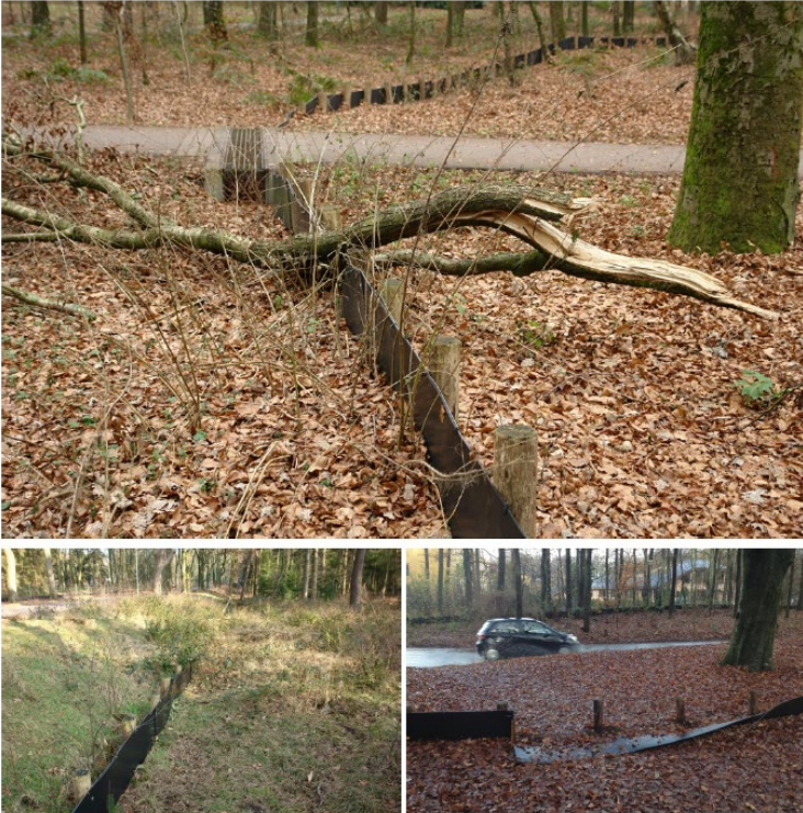
Figuur 3 Boven een voorbeeld van een zware tak op de HDPE kunststofplaat, linksonder het overgroeien van de platen door vegetatie, in dit geval met gewone braam ( Rubus fruticosus ), en rechtsonder voorbeeld van moedwillig kapot gemaakte HDPE kunststofplaat en spandraad.
